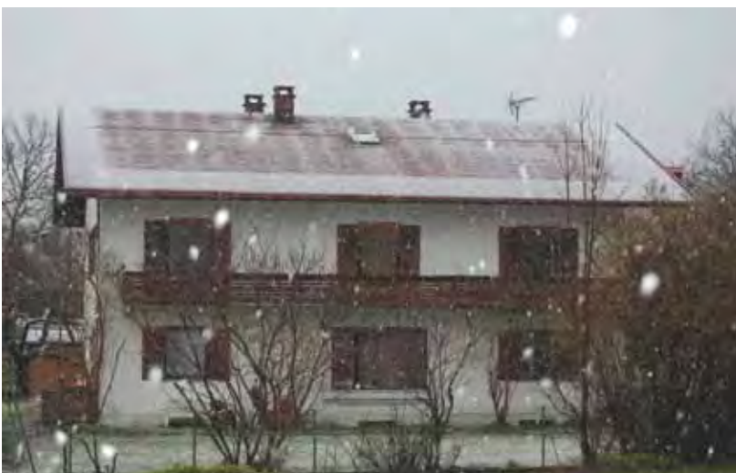
Bild 1: Hier wird teure Heizenergie zur Schneeschmelze auf dem Dach verwendet, eine Dämmung würde bares Geld sparen!
